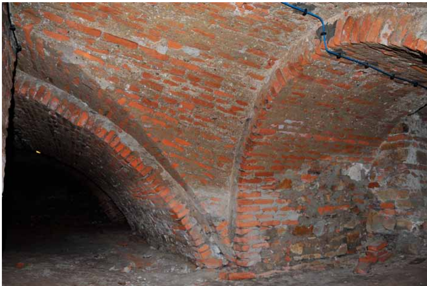
Fot. 36. Płaszcze wzmacniające sklepienie krypty głównej i sklepienie przedsionka jednej z krypt południowych, nałożone podczas odbudowy po 1734 roku
