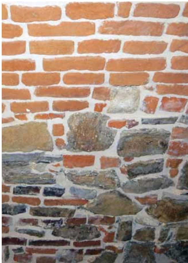
Fot. 54. Fragment sklepienia kamiennieo-ceglanego spływającego do posadzki w krypcie głównej z widocznymi kamiennymi wyoblonymi elementami kolumn, najprawdopodobniej z małej architektury, która stanowiła wyposażenie katedry przed upadkiem sklepienia. Elementy kamienne zostały wtórnie wmurowane w płaszcz wzmacniający dodany do odbudowanych sklepień po 1734 roku
