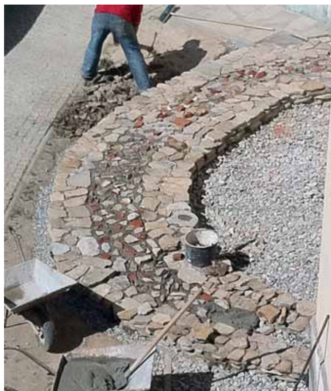
Fot. 51. Odtworzony obrys kaplicy z czasów bp. W.H. Sierakowskiego w narożu południowo-zachodnim bazyliki archikatedralnej (w trakcie prac)
