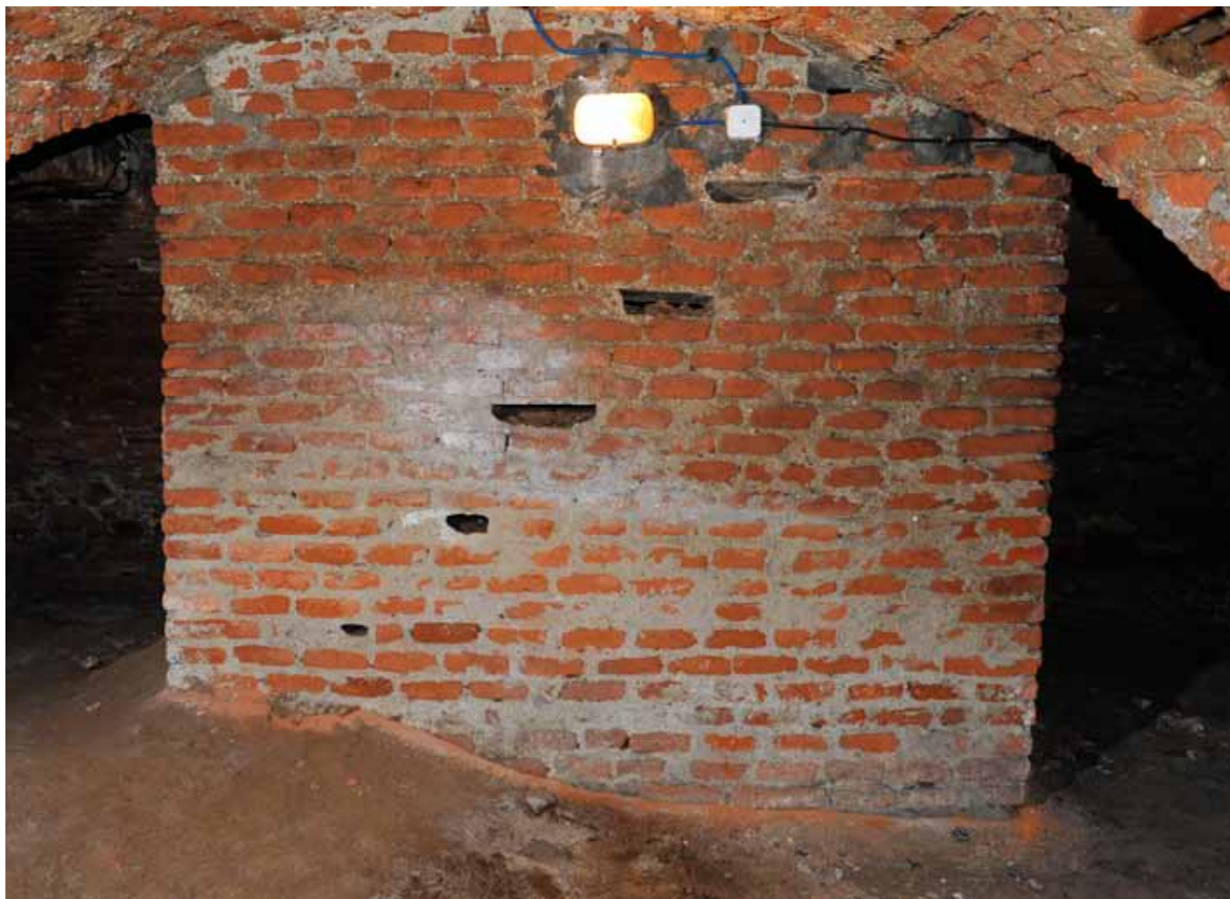
Fot. 14. Fragment nieczynnego zejścia do podziemi – widoczne ślady gniazd do osadzenia drewnianych stopnic
