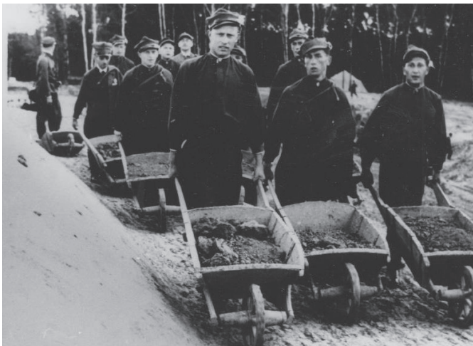
Fot. 83. Budowa kopca im. Józefa Piłsudskiego w Krakowie przez uczestników zlotu w 1935 r. (zbiory Muzeum Historycznego m. Krakowa, sygn. FS 8894/IX)
