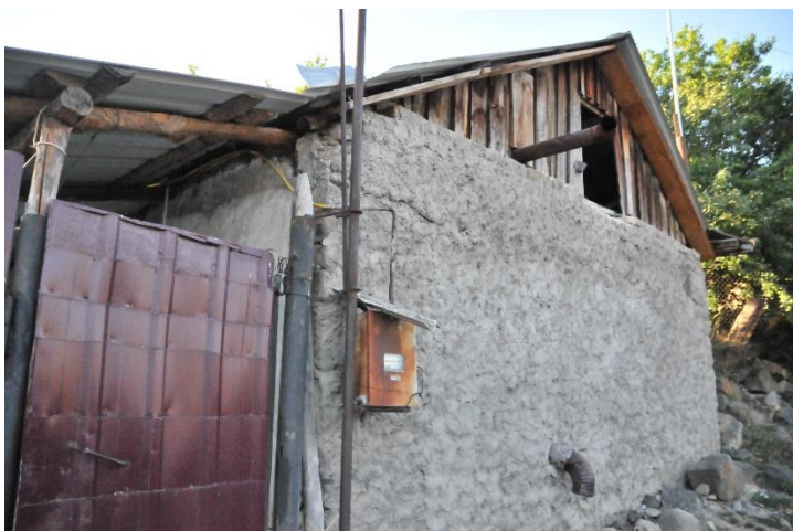
Fot. 34. Skrzynka gazowa i odchodzący od niej system plastikowych rurek, doprowadzających gaz do domu
